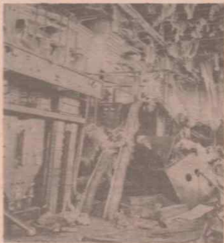
« Les locaux de F.R.S. après plasticage »
